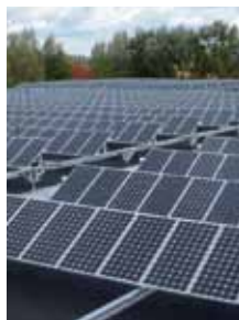
Installatie van 350 kWp Jumi Plastics Diepenbeek
